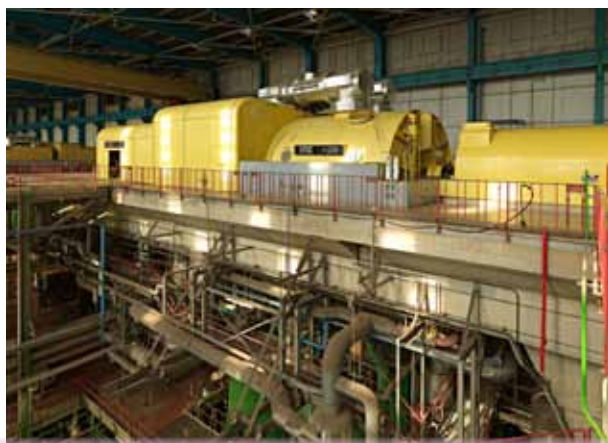
Salle des machines avec turbine à vapeur et alternateur
