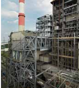
Chaudière, DeNO x , électrofiltre (de droite à gauche)
